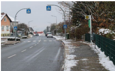
Abbildung 2-19: Fehlender Wetterschutz Haltestelle Rheinstahlring stadtauswärts
